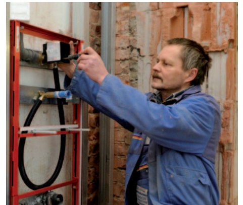
Urinalmodule mit TECE-Unterputzdruckspüler: Vier moderne Urinale sind pro Sanitäranlage im Einsatz.
