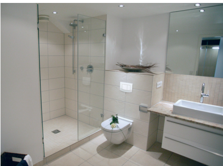
Funktionelles Badezimmer – die Vorwandinstallation von TECE sorgt für zusätzliche Ablagefläche.
