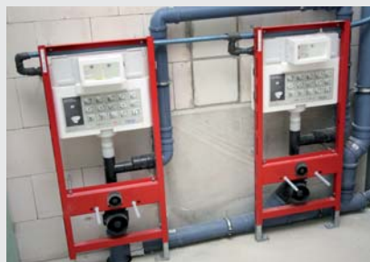
Eine Frage des Komforts: Die TECE-WC-Module sorgen für gute Luft in den Artiga-Sanitäranlagen.
